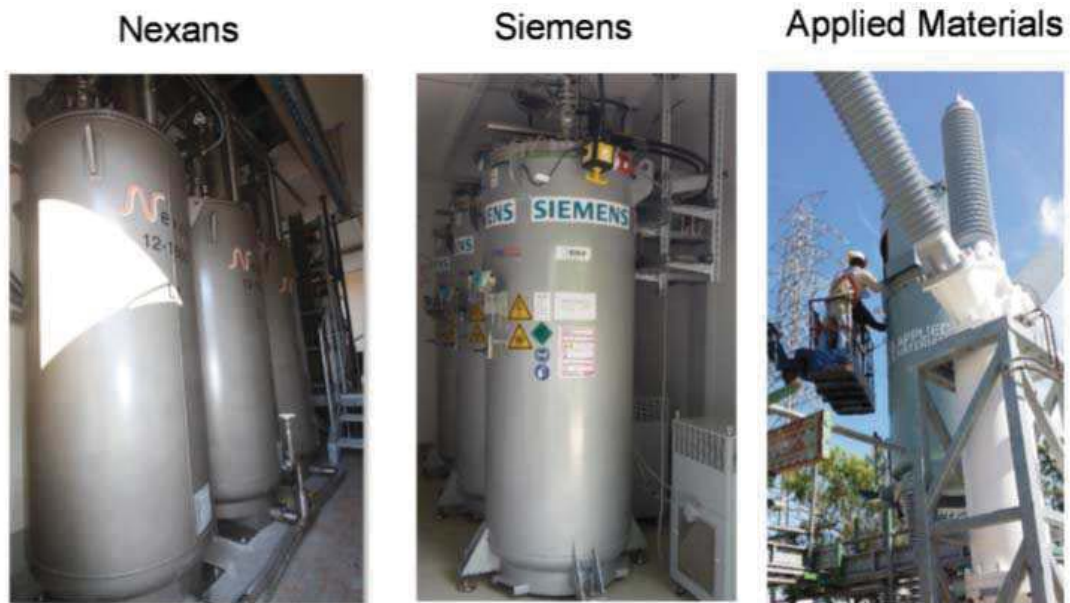
Fig. 2.20 - Exemplos de DLCs supercondutores em aplicação.
